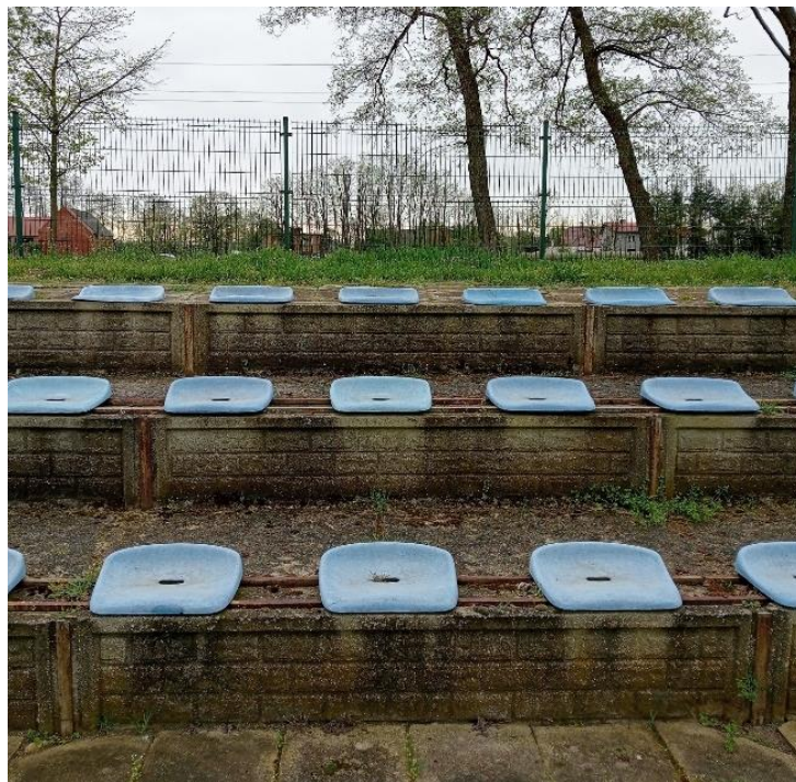
Ryc. 20 Zniszczone trybuny przy kompleksie sportowym za Urzędem Gminy
